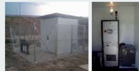
Vista general de la caseta (exterior e interior) que incorpora el sistema de ozonización, totalmente automatizado y monitorizado, de ACTUALIA Tecnología instalado en Zaragoza.
